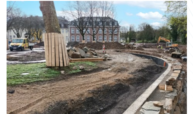
Bei Scheiblerpark und Hillstraße 1-7 befinden sich städtische Projekte im Tief- und Hochbau in direkter Nachbarschaft zueinander.
