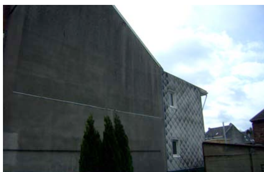
Ungedämmte Brandwand mit hohem Heizwärmeverlust
